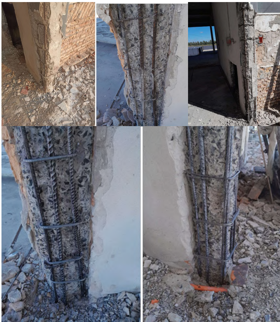
Fotografías 14, 15 y 16. Vista de los daños por corrosión en las armaduras de los pilares de la planta alta, se evidencia la rotura des estribos.
