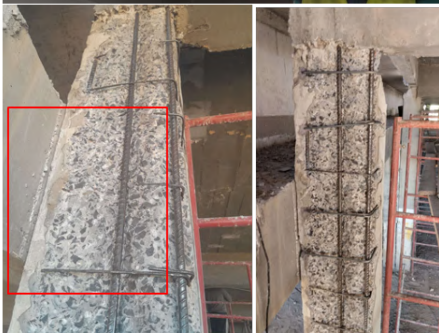
Fotografías 9 y 10. Vista de la rotura de estribos verificados en el pilar y de los anclajes de estribos nuevos de refuerzo.
