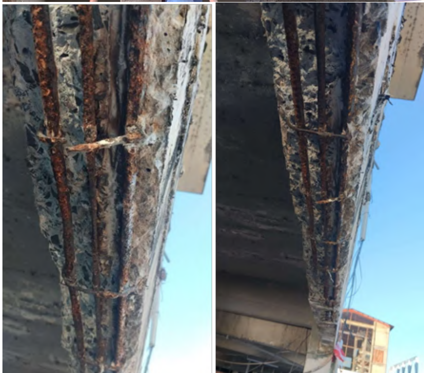
Fotografías 6 y 7. Vista de los daños por corrosión en la viga, se evidencia la pérdida de sección de la armadura principal y la rotura de estribos en esta.
