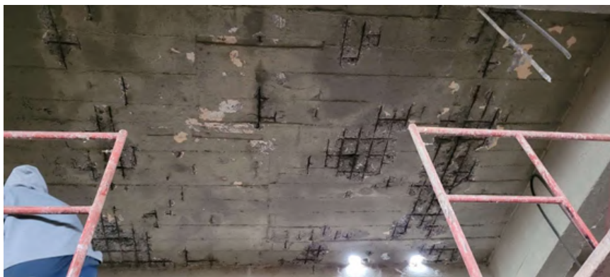
Fotografía 1. Vista de los daños por corrosión en las armaduras de la losa antes de la reparación estructural.
