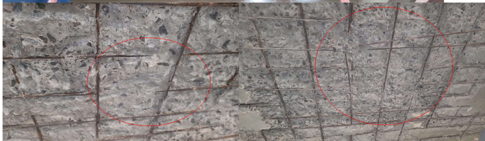
Fotografías 2 y 3. Vista de la rotura de las armaduras principales de la losa, evidenciadas en los trabajos de escarificado.
