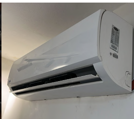
Acondicionador de aire patrimoniado Dpto. de comunicaciones
